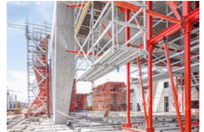
PERI UP modularna skela u kombinaciji sa VARIOKIT sistemom omogućava bezbedan pristup različitim radnim područjima.
