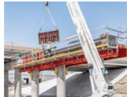
VSS omogućava nezavisnu upotrebu bočne oplata. To omogućava demontažu oplata sledećeg dana, kao i komforno obavljanje armiračkih radova.
