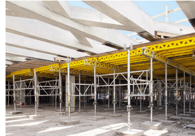
MULTIFLEX je služio za izradu betonskih greda na licu mesta, PEP podupirači su bili povezani PRK ramovima.
