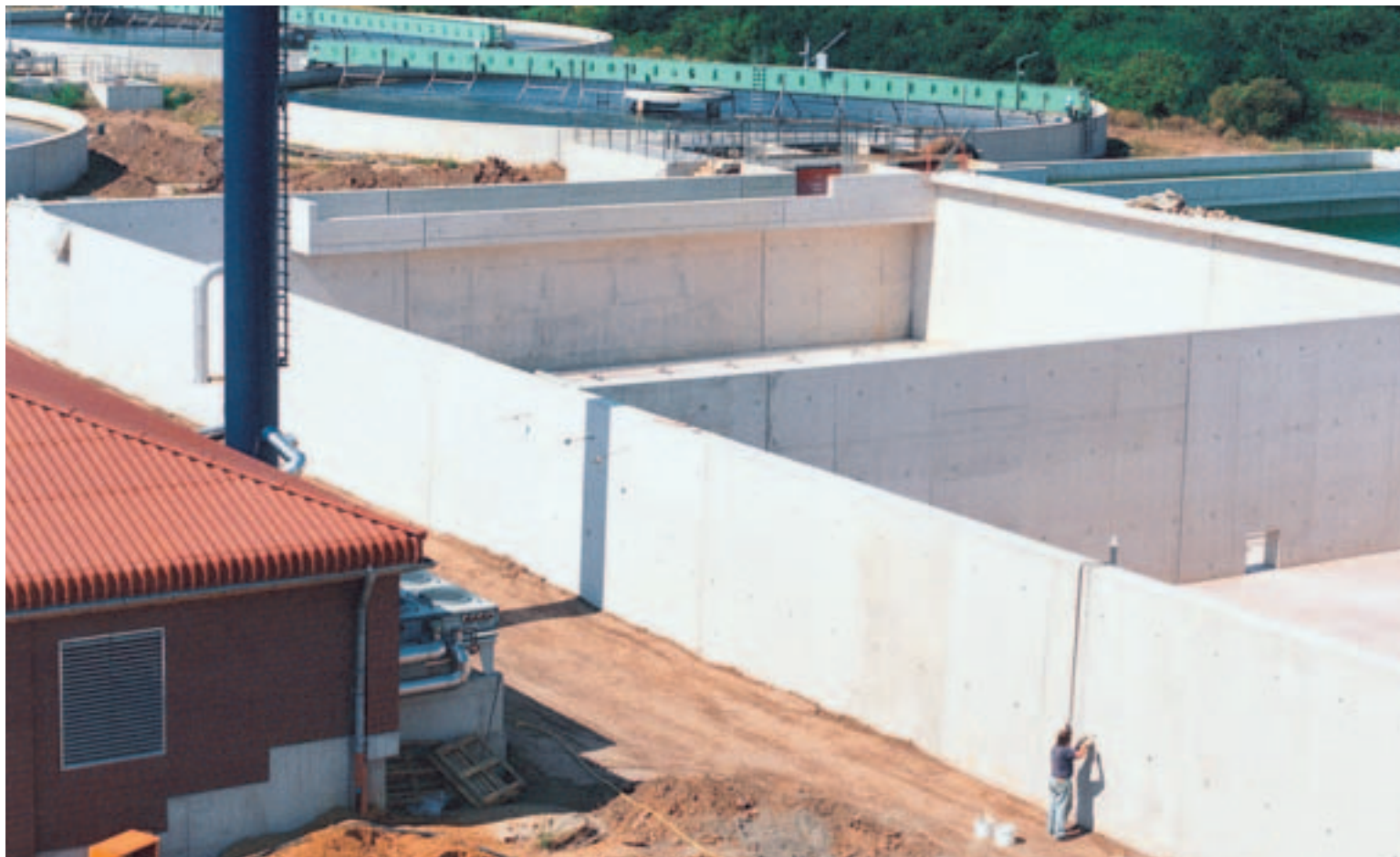
Postrojenje za prečišćavanje otpadnih voda, Hameln, Nemačka.
